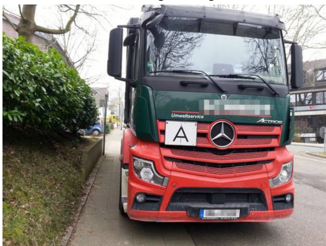
Bild 14: Die Achslast eines LKW lässt Gehwegplatten brechen.
